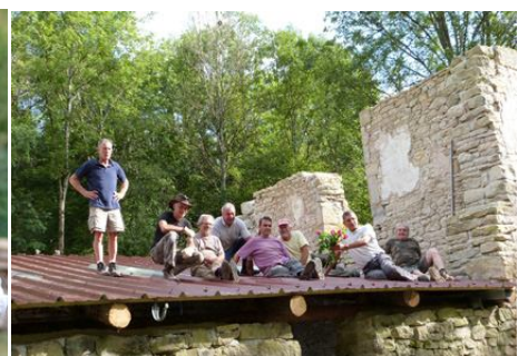
Gros chantier de l'année : la maison des maîtres a été consolidée, couverte, ses abords nettoyés et mis en valeur
